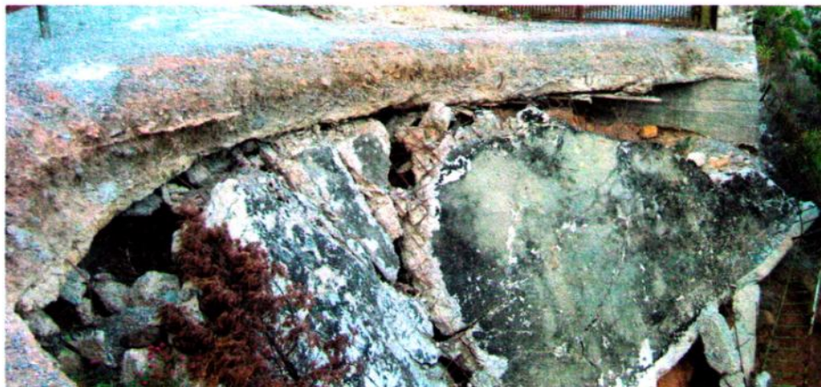
Рис. 167. Оползень на горном склоне разрушил дорогу
